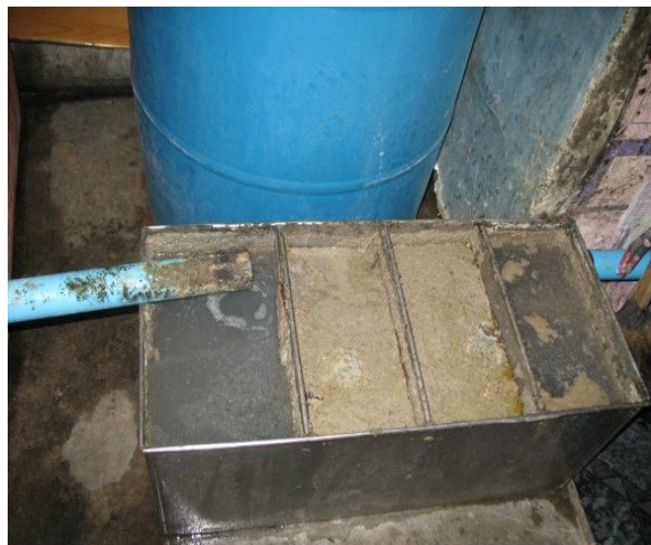
ภาพที่ 4.6 ถังดักไขมันอย่างง่ายแบบที่ 1 (ติดตั้งที่ร้านค้า)
