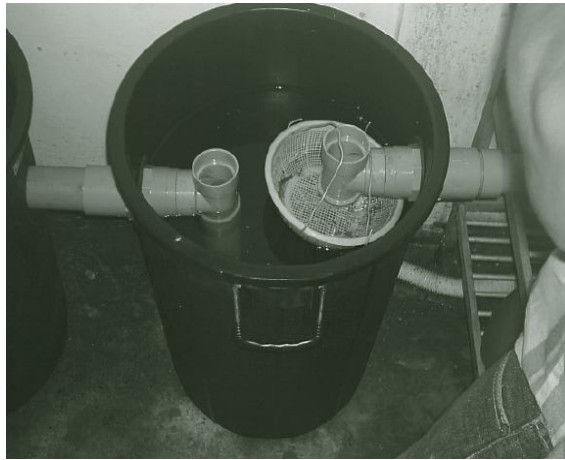
ภาพที่ 4.7 ถังดักไขมันอย่างง่าย แบบที่ 2 (ติดตั้งที่บ้าน)
